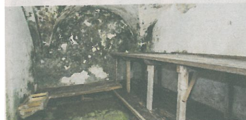
Schimmel an den Wänden: Das Gebäude hat Sanierungsbedarf.
